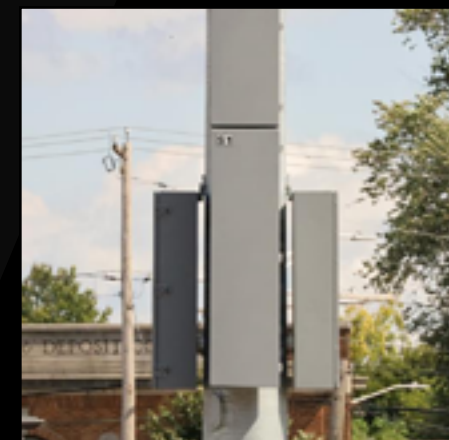
CAJAS CON ACCESO DE CABLES O MONTADAS EN POSTES
