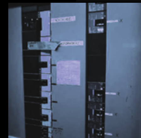
INFRAESTRUCTURA DE ALIMENTACIÓN Y CONTROL
