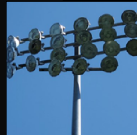
CONFIGURACION EN ESTRUCTURA DE MONTAJE
